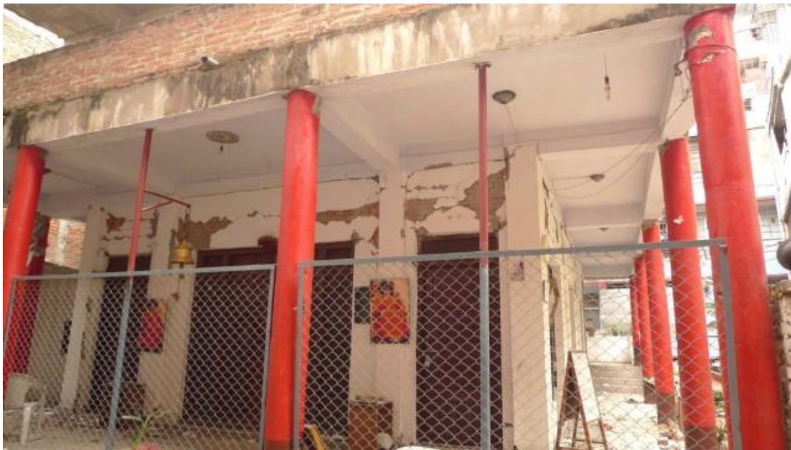
Oštećeni Sai Centar
